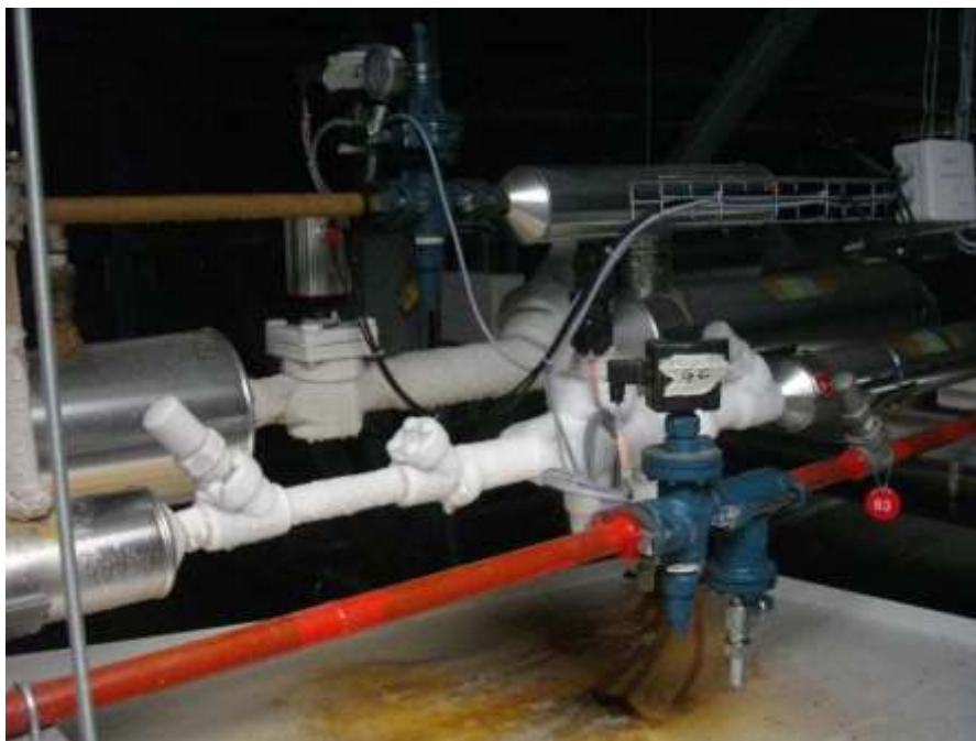
Figure 20 : Station de vanne sur le circuit ammoniac dans les combles
