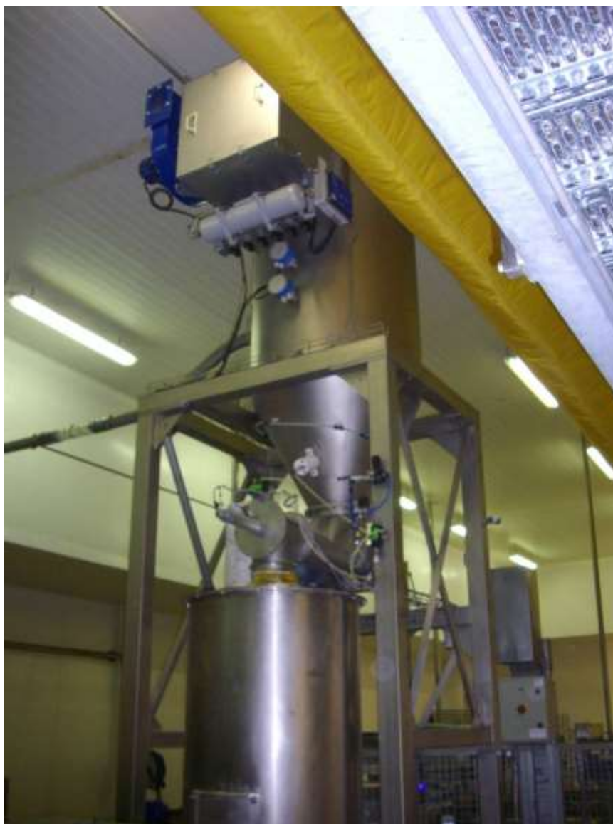
Figure 4 : Trémie tampon de l'atelier de viennoiserie 1
