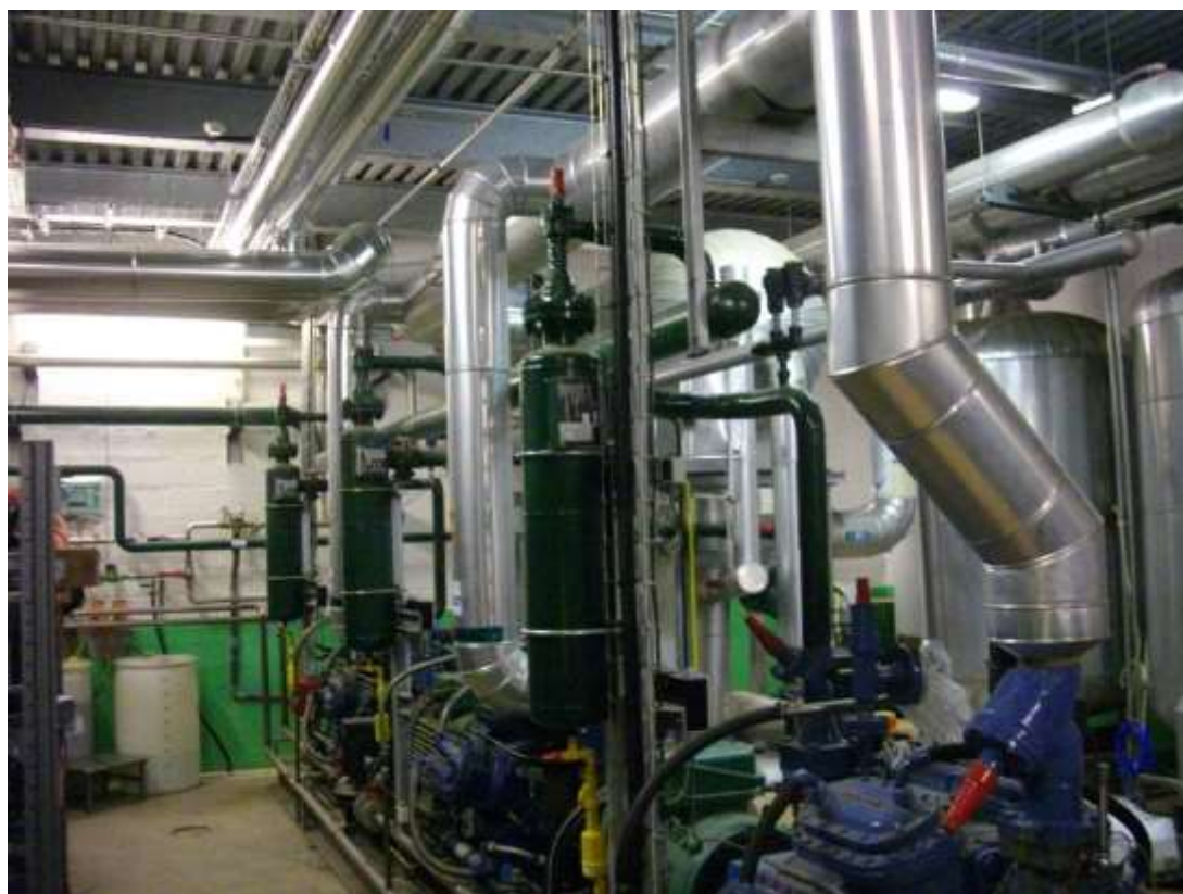
Figure 15 : Salle des machines 1 et 2
