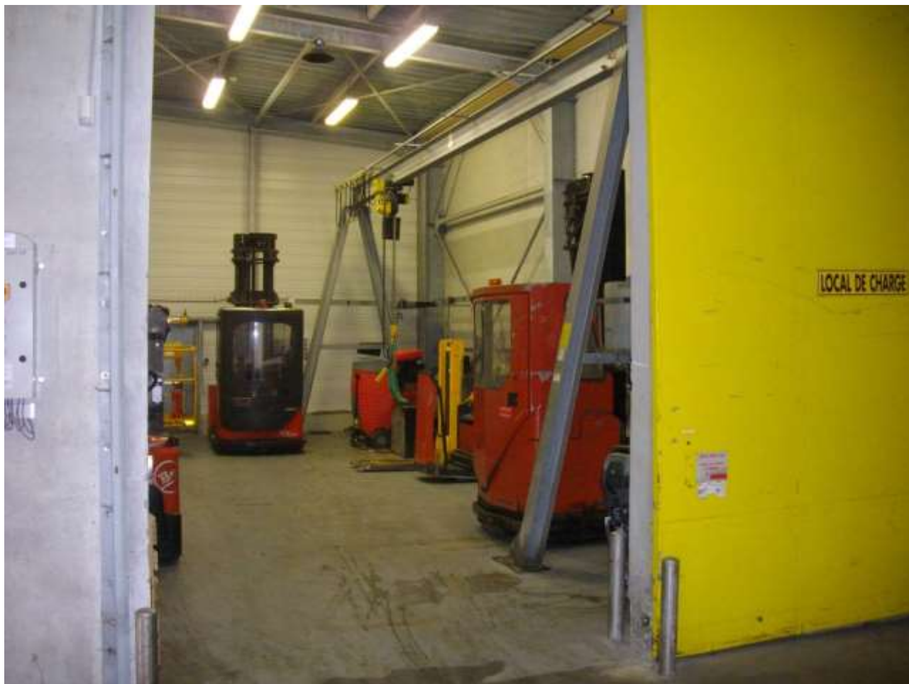
Figure 21 : Salle de charge des batteries
