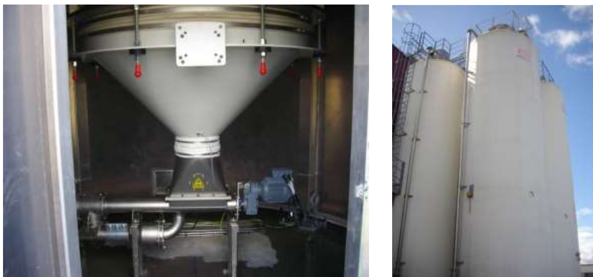
Figure 13 : silos de stockage extérieurs
