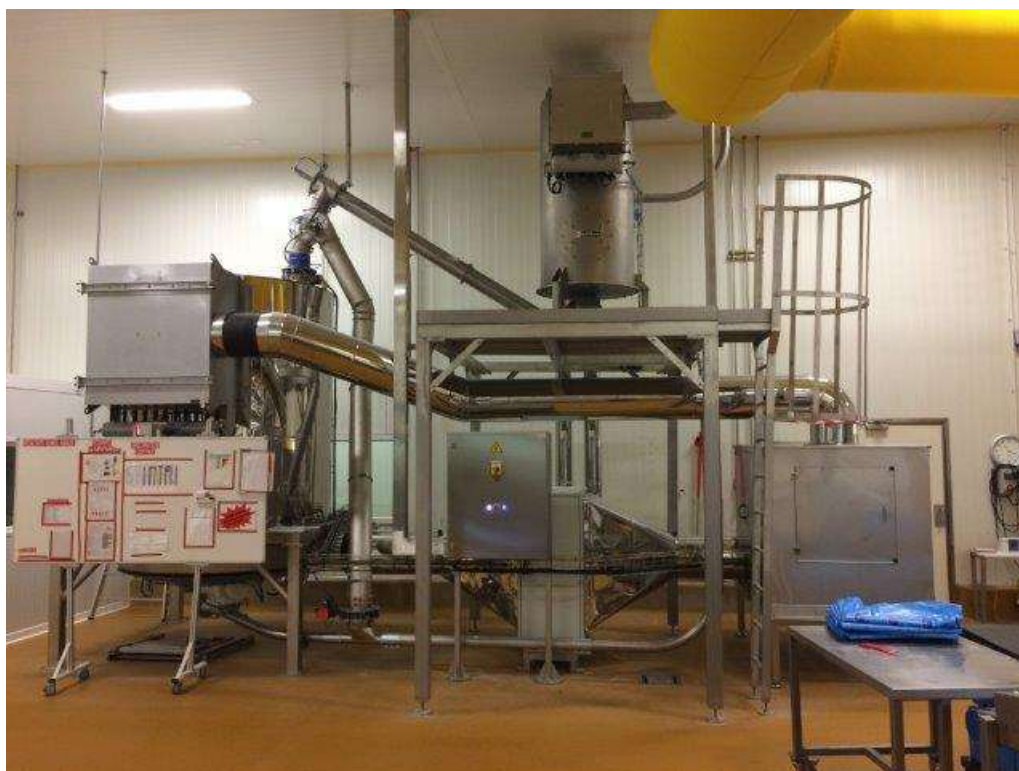
Figure 9 : Refroidisseur de l'atelier viennoiserie 2
