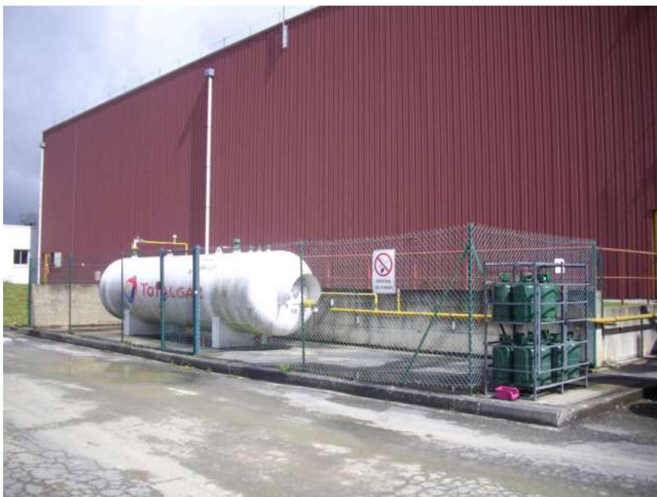
Figure 22 : Cuve de stockage de propane
