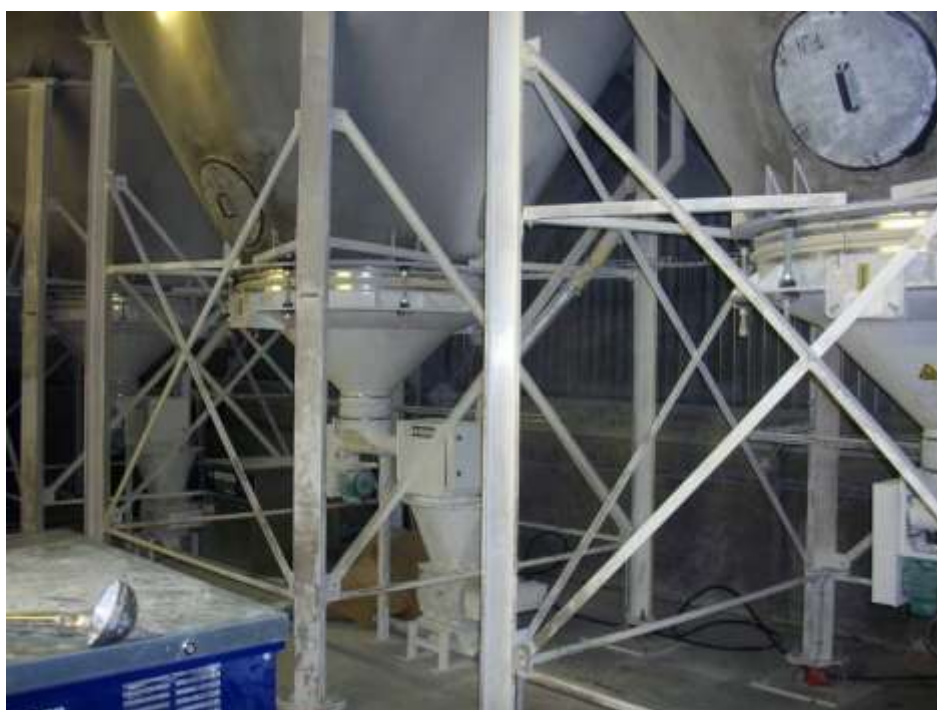
Figure 14 : Local contenant les silos de stockage intérieurs
