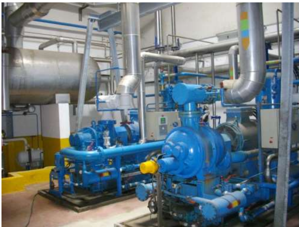
Figure 16 : Salle des machines 3 et 4
