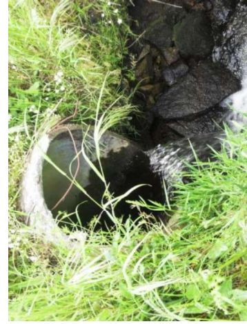
Photo 15 – Buse (OH2b- aval) de diamètre 600mm
