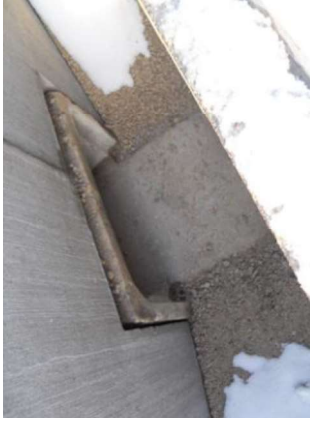
Photo 142- Exemple de battochoduc (source : CEREMA)
